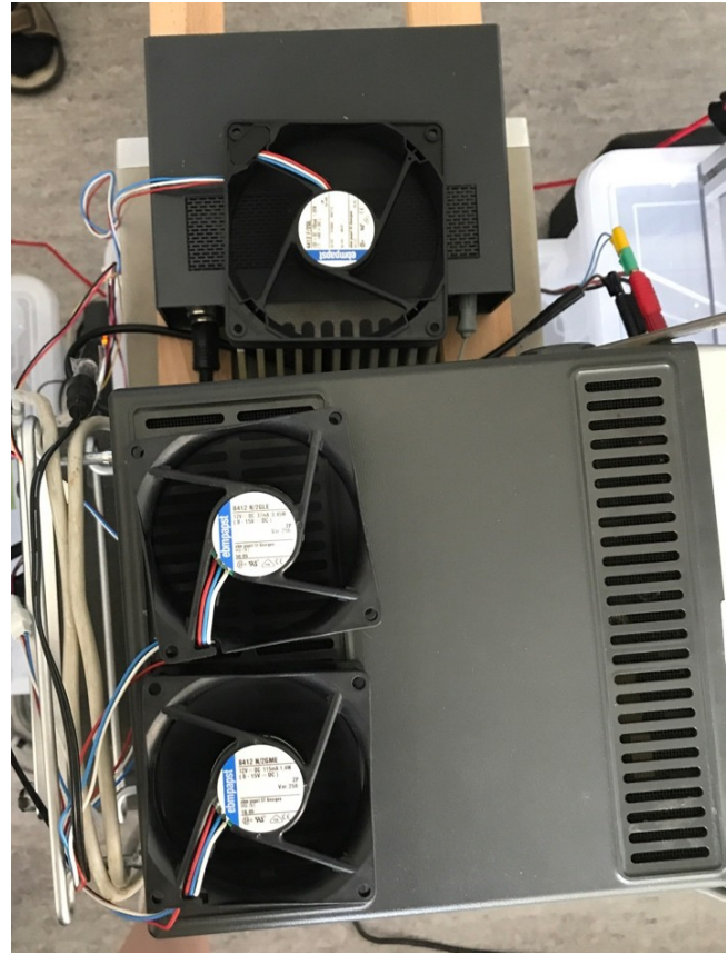
Abb. 5: Aufsicht Generator und Verstärker mit Lüfter.
